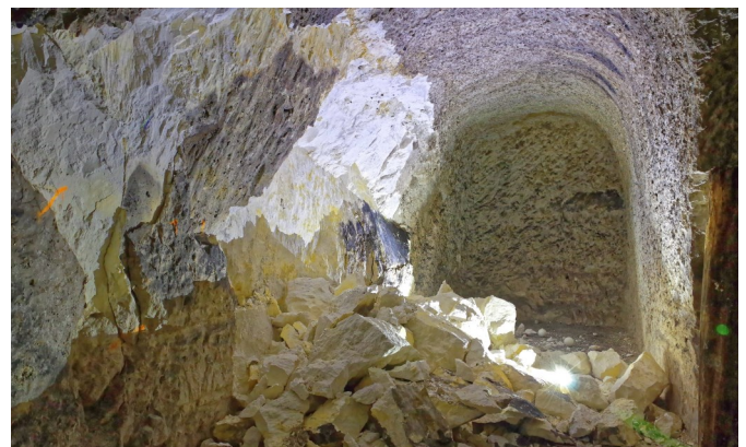
Exemple d'effondrement dans une carrière de craie
